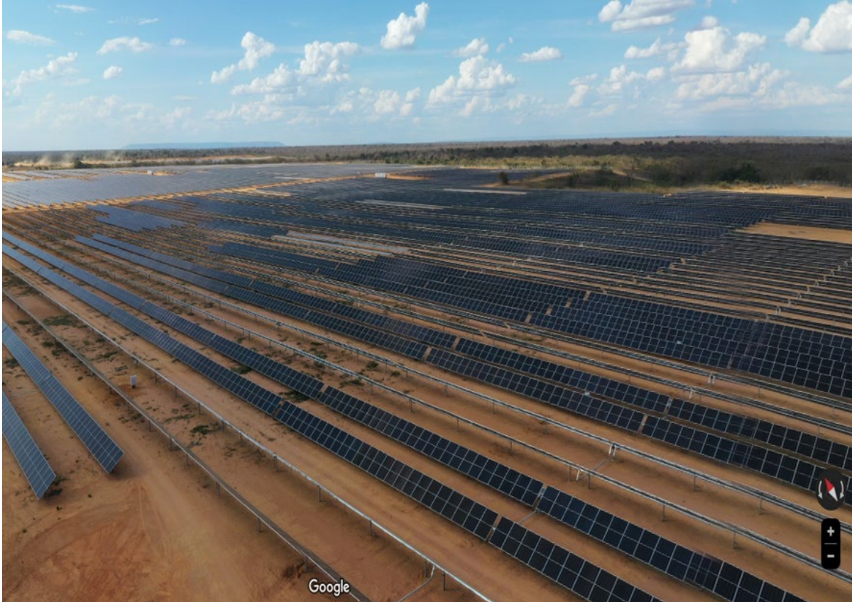
Figura 7 - Usina solar Sol de Jaíba – Jaíba/MG
