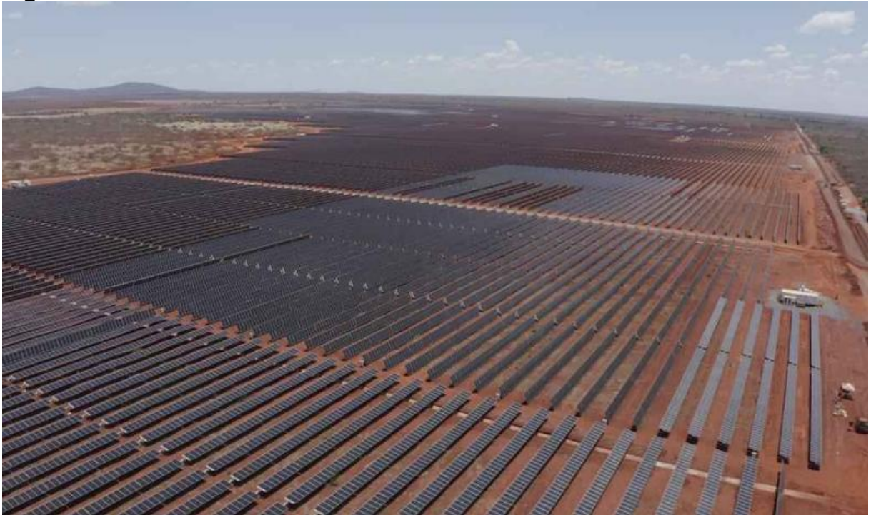
Figura 7 - Usina solar Sol do Cerrado – Jaíba/MG
