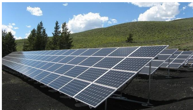
Figura 17 - Painéis solares captam a energia do Sol.
