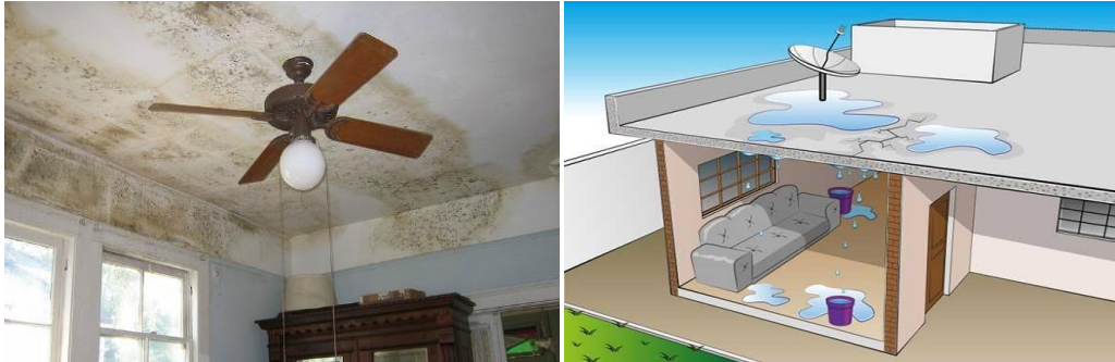
Figura 12 e 13: Infiltração na laje
