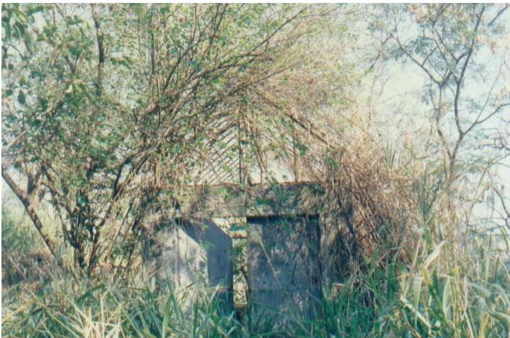
Figura 4. A vegetação toma conta das construções abandonadas.
