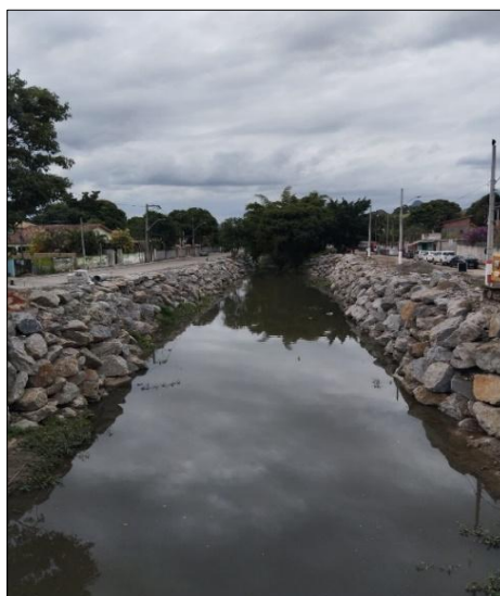
Figura 28 – rio Mumbuca, Erosão das Margens
