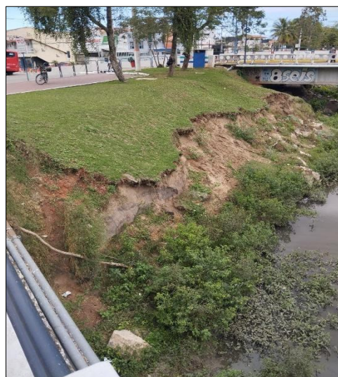
Figura 27 – Erosão das Margens
