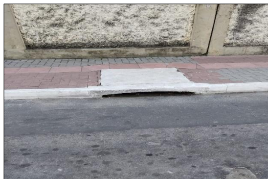
Figura 17 – Boca de Lobo
